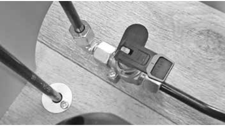
Isıtma sistemi kapatma vanası
